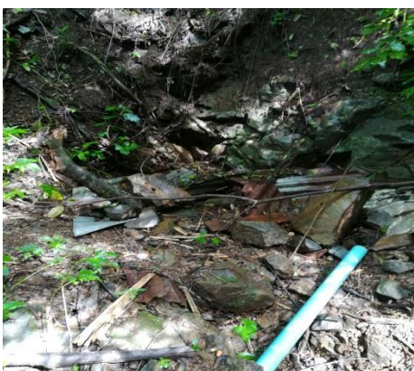
Foto 5: Captación naciente. Fuente: autor
