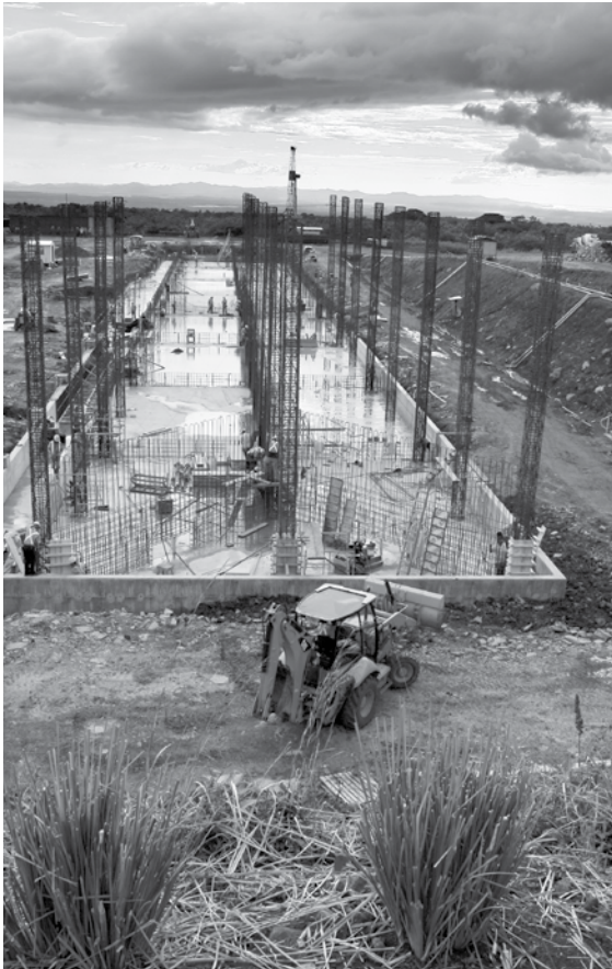
Proyecto Geotérmico Las Pailas. Guanacaste, Costa Rica
