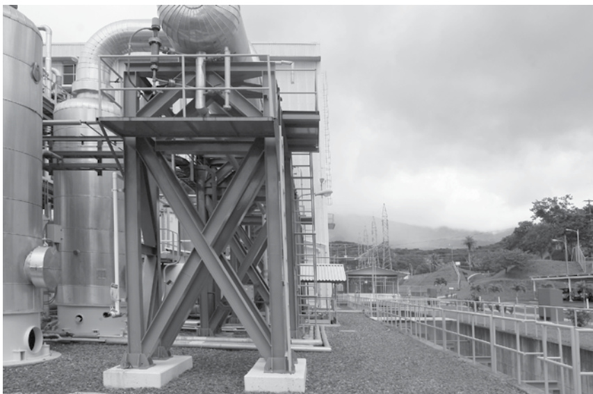
Proyecto Geotérmico Las Pailas. Guanacaste, Costa Rica
