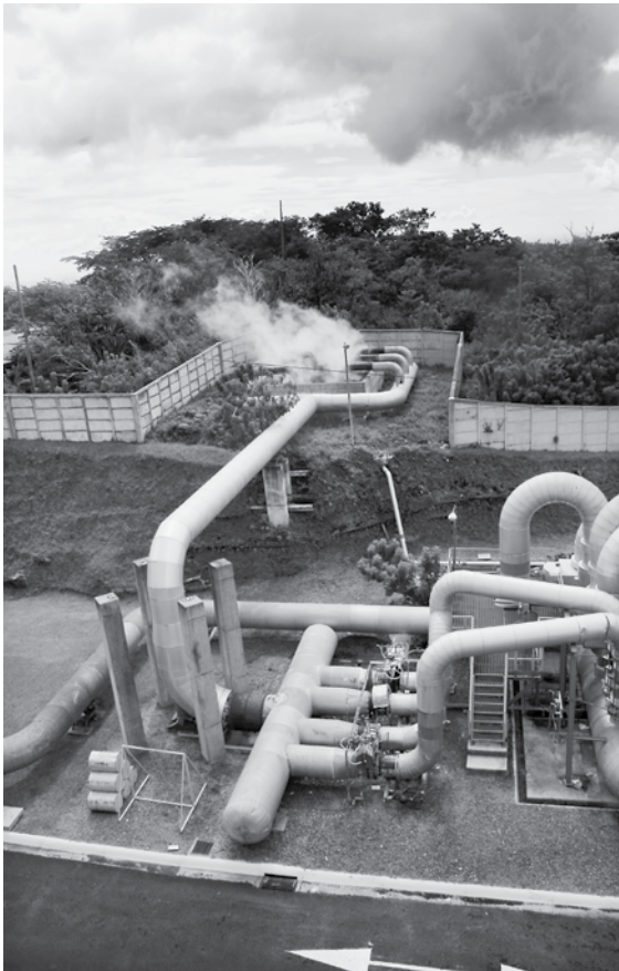
Proyecto Geotérmico Miravalles. Guanacaste, Costa Rica
